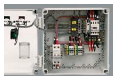
Caixas vazias com equipamento instalado na calha DIN e na placa de montagem
