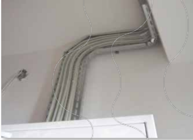
Kablolar bina içerisinde tek bir kanala döşenirler.
