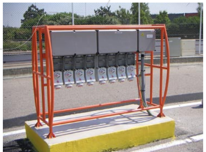
Terminal de Contentores, Le Havre – França
