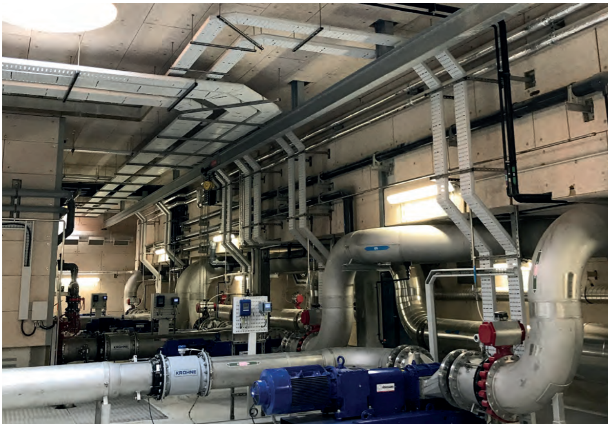
Tratamento de águas: ETAR
