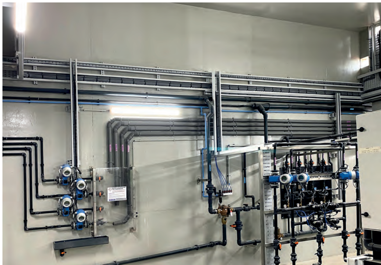
Tratamento de águas
