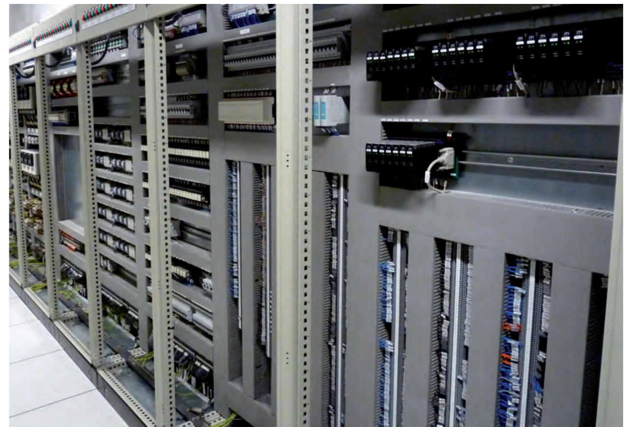
Tratamento de águas
