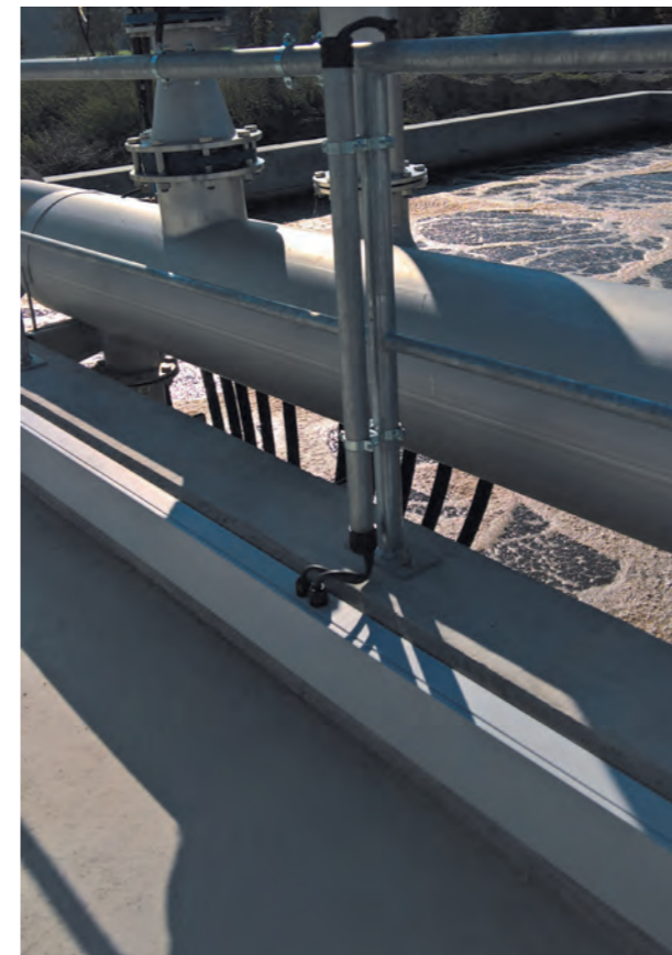
Tratamento de águas: ETAR
