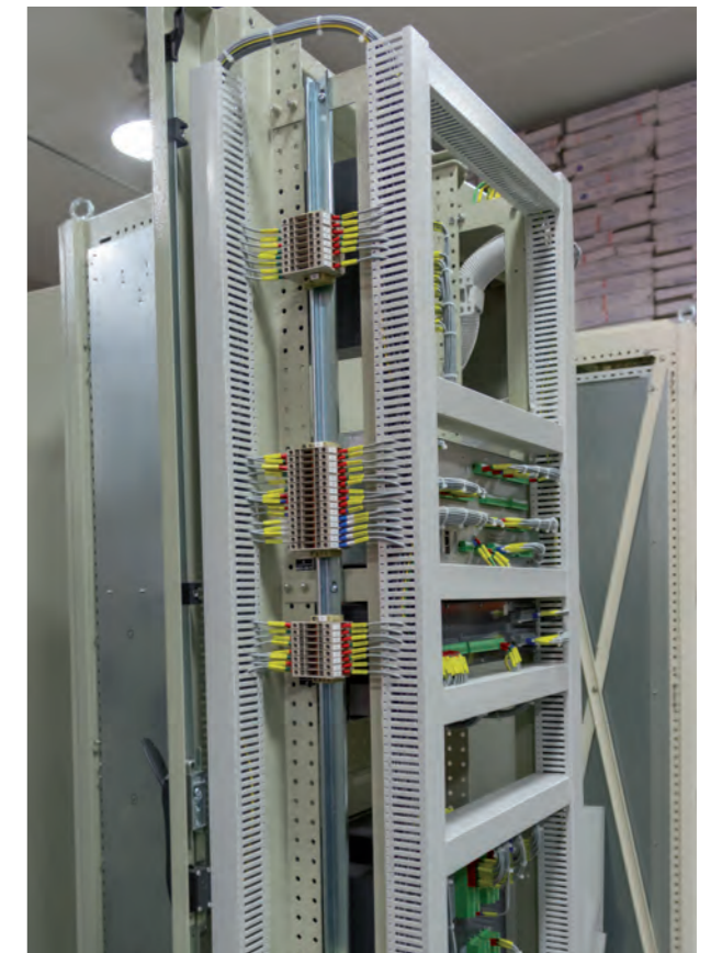
Produção e distribuição energia elétrica
