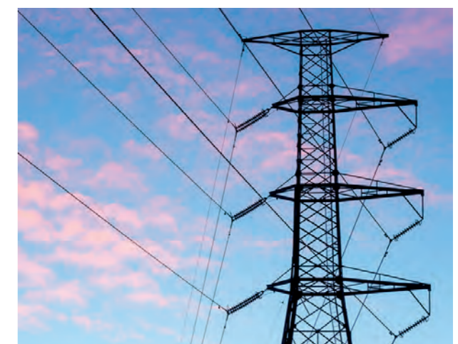
Redes de distribuição de energia elétrica
