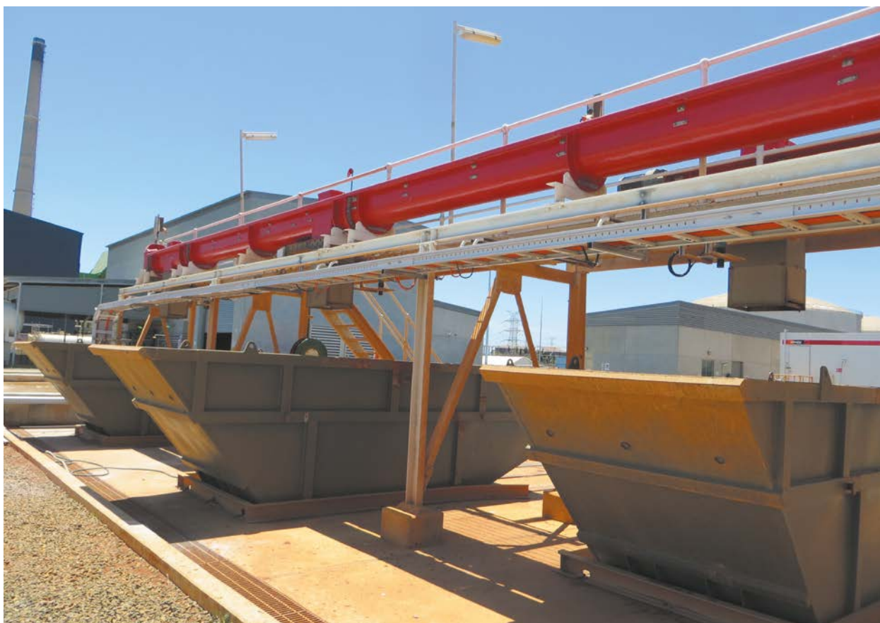
Tratamento de águas: estação dessalinizadora
